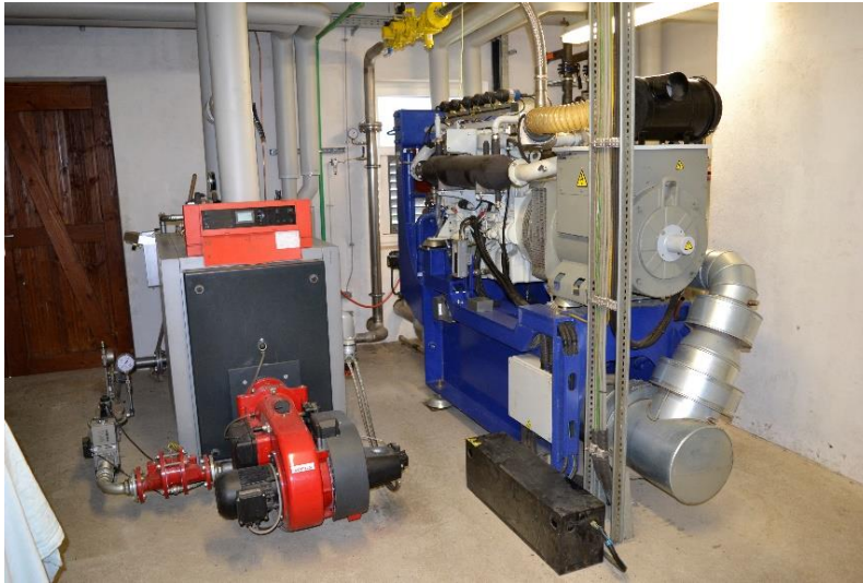
Abbildung 11: Biogas-BHKW 75 kW elektr. Leistung (rechts) und Notheizkessel für Biogas / Heizöl an der BGA Clausnitz
