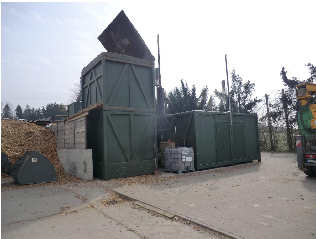
Abbildung 57: Anlage zur Holzvergasung mit Holz Trocknung (links) und BHKW-Modul (rechts) der Firma Radßuweit
