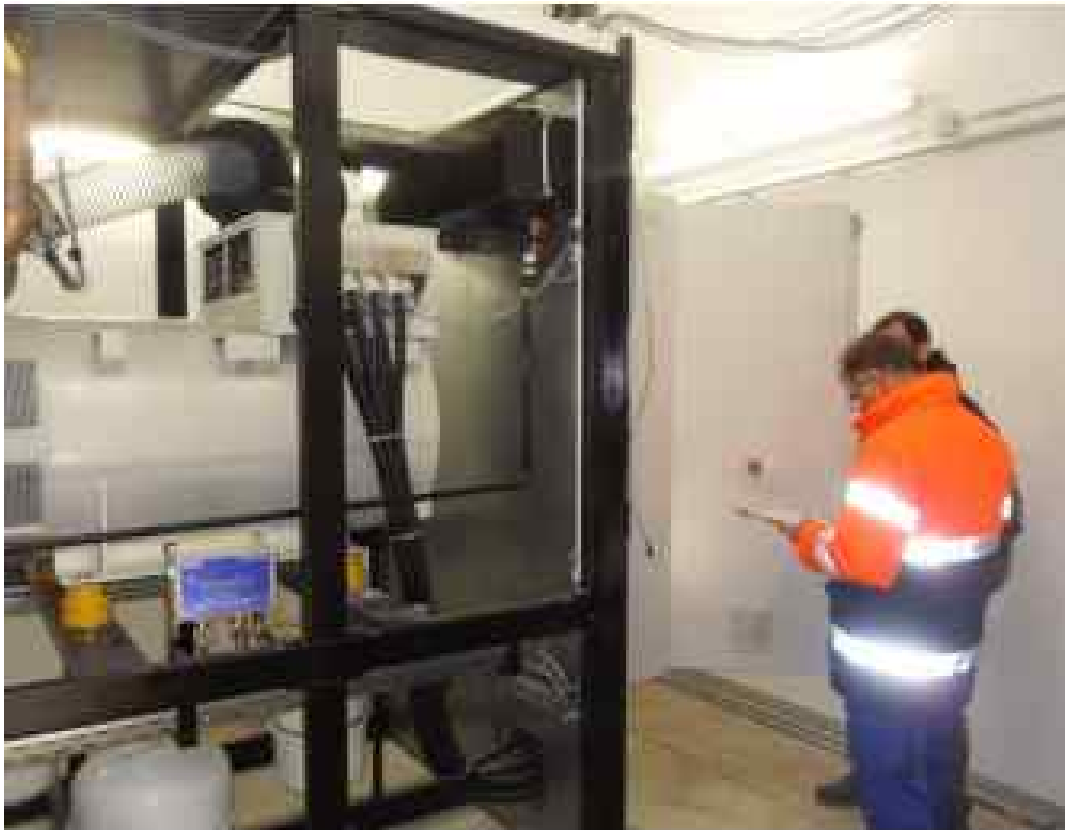
Abnahme des BHKW durch ENSO
