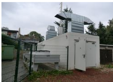
Satelliten-BHKW in Burkhardtsdorf direkt am Freibad
