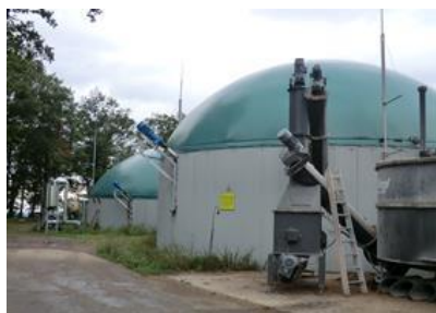
2011 installierte BGA mit Hydrolyse im Vordergrund
